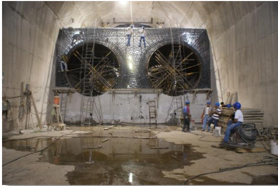
Armado de refuerzo en el exterior de los disipadores de energía, empotrado hacia ambos lados (CFE La Yesca, 2013). 5 de mayo de 2012
