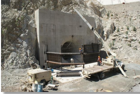
Armado de la rejilla de la bocatoma (CFE La Yesca, 2013). 12 de abril de 2012
