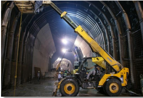
Colocación de marcos metálicos y malla electro soldada; y recubrimiento de concreto en zona de transición (CFE La Yesca, 2013). 30 de julio de 2011
