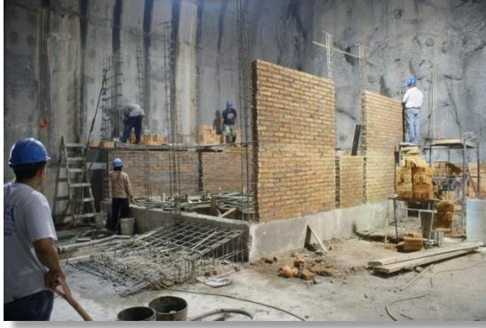
Construcción de la caseta de control (CFE La Yesca, 2013). 10 de diciembre de 2011
