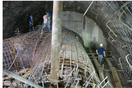
Bifurcación con su armado de refuerzo en el exterior y bóveda (CFE La Yesca, 2013). 15 de octubre de 2011
