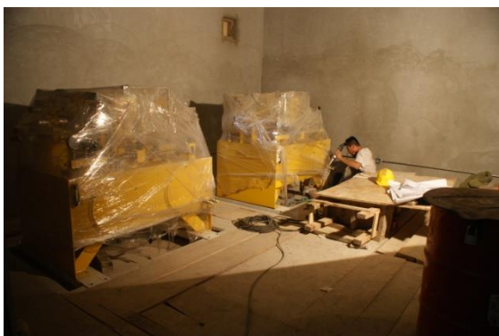
Colocación y ajustes de los controles de desagüe de fondo (CFE La Yesca, 2013). 15 de febrero de 2012
