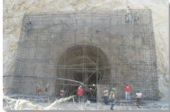
Armado de refuerzo en la bocatoma (CFE La Yesca, 2013). 29 de febrero de 2012
