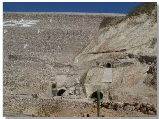
Cortina, túneles 1 y 2, y desagüe de fondo (CFE La Yesca, 2013). 08 de marzo de 2013
