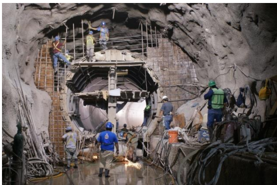
Colocación de la cimbra entre la separación de la conducción con blindaje, del túnel de conducción aguas arriba, (CFE La Yesca, 2013). 10 de diciembre de 2012
