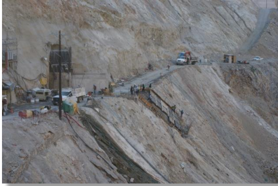
Construcción de la platilla de la ladera (CFE La Yesca, 2013). 15 de febrero de 2013
