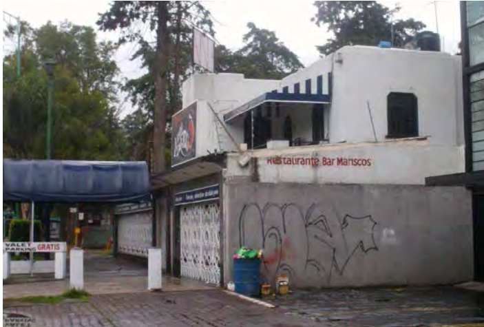
Fig. 3.10. El edificio conserva múltiples muestras de invasión que obstruyen el pleno goce visual que implica la más simple contemplación:
