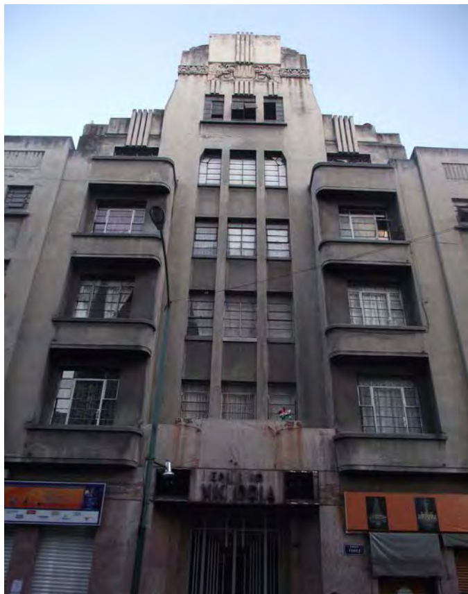
Fig. 2.4. Edificio Victoria. Autoría de Francisco J. Serrano, inmueble gravemente afectado por el descuido. A simple vista se aprecian las grietas y acumulaciones de humedad en muros.
