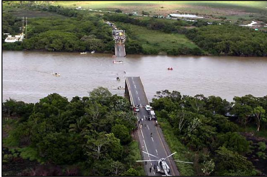
Figura 1.6.5 Colapso del puente Tonalá I
