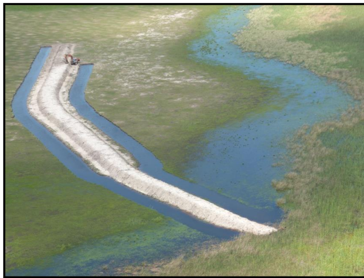
Figura 1.8.1 Construcción de terraplén cortando el cauce natural del estero Gallo Sapukay en Argentina
