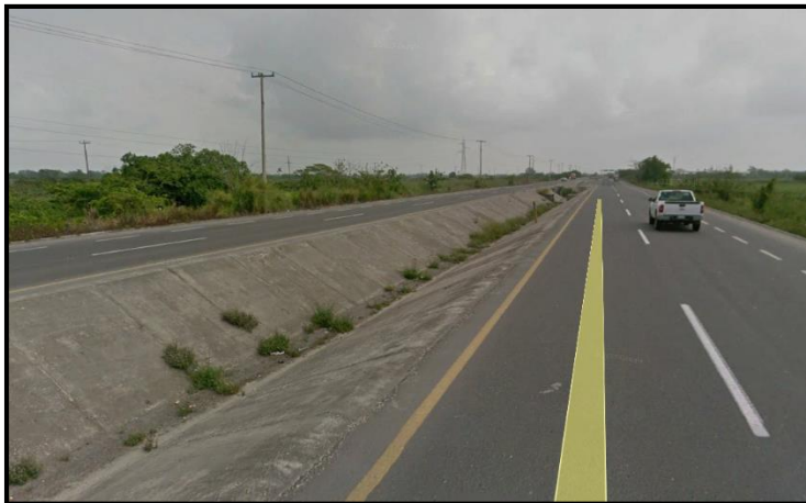
Figura 2.3.6 Canal de drenaje pluvial entre los cuerpos A y B del km 42+160.00-44+460.00
