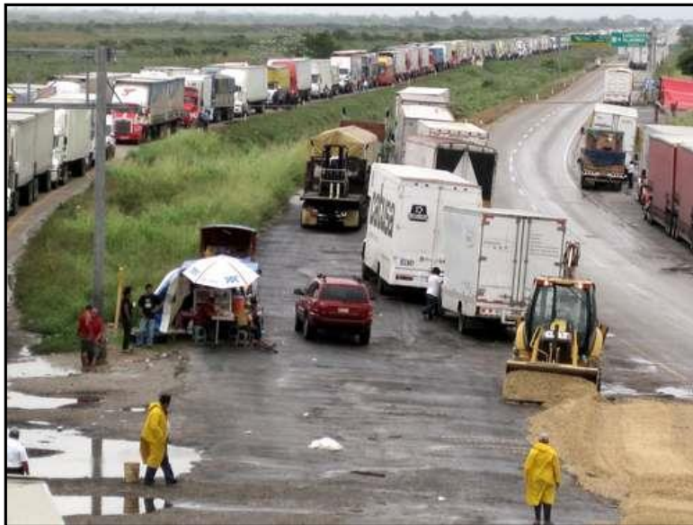
Figura 1.6.2 Medidas de rehabilitación por inundación en la carretera Villahermosa-Coatzacoalcos en el año 2009.
