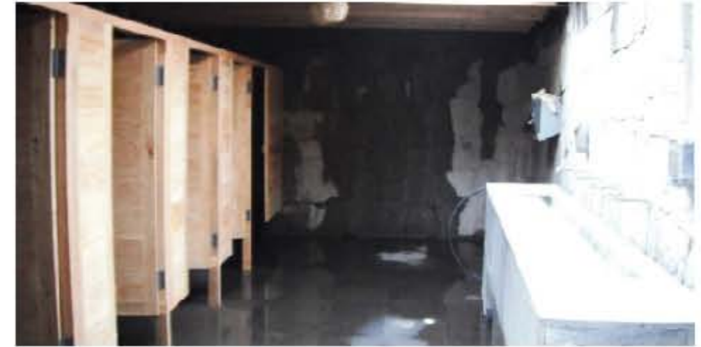
Imagen 4.12: Vista interior de los baños después de un día lluvioso.
