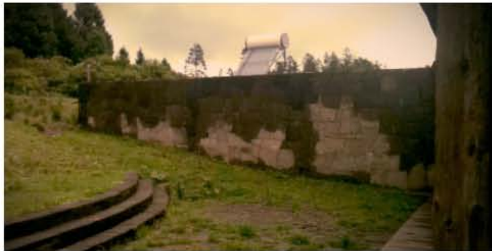
Imagen 4.11: Ésta es una imagen del único calentador solar que hay en el conjunto. No está escondido de los usuarios y la inclinación del calentador no es la adecuada para la captación máxima de los rayos del sol. Como en el ejemplo anterior, no hay razón de que haya ya que el uso de agua caliente no es necesario al ser un lugar público.
