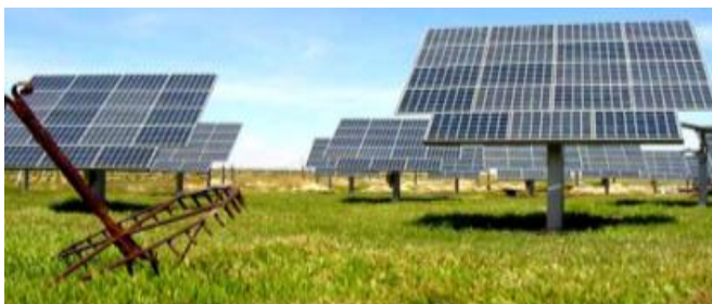
Campo de Paneles Fotovoltaicos.
