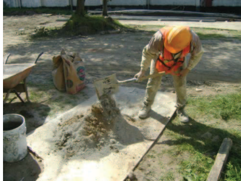
Primero se realiza la mezcla entre el agregado fino con el cemento
