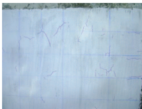
Primeras marcas de fisuras expuestas el día 11 de Octubre de 2010
