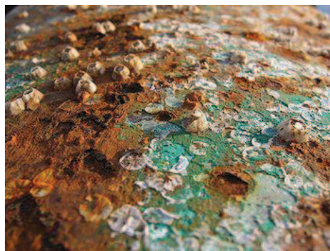
Imagen de Corrosión en el Acero
