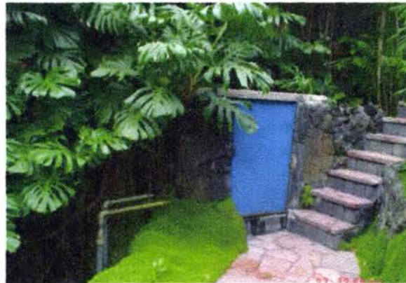
ÁREA DE EQUIPOS, BOMBAS, CONTROLES DE HUMEDAD Y RIEGO.
