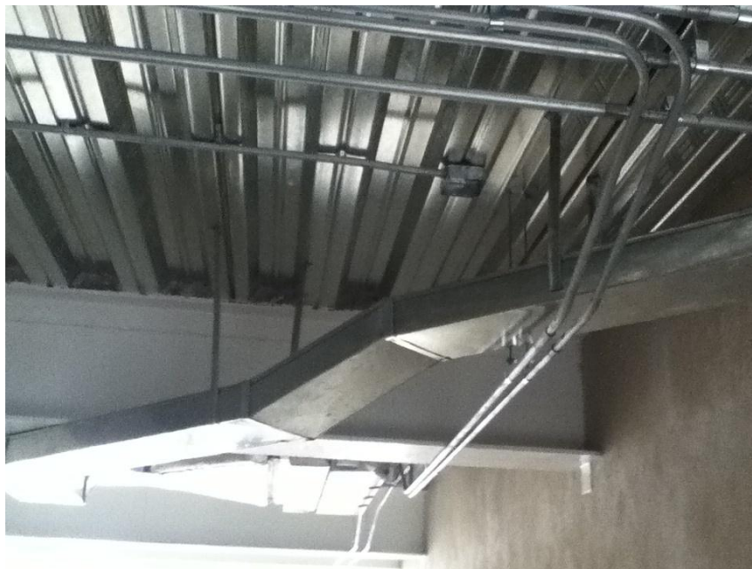
Figura 3.4.1 ductos eléctricos y de aire acondicionado
