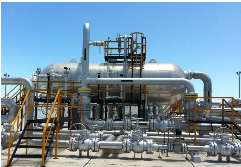
Figura 5.21.- Separador horizontal trifásico de alta presión
