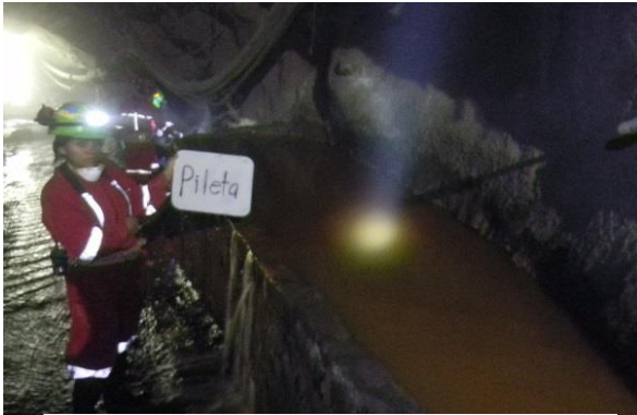
Figura 3-7 Pileta con derrame
