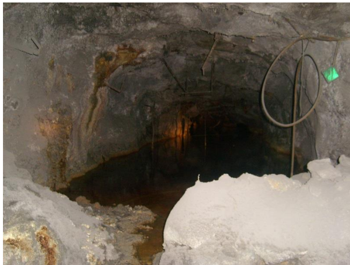
Figura 5-6 Rebaje con presencia de DAM
