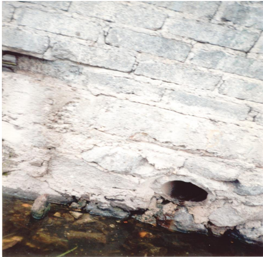
Ilustración 1. Vertido clandestino de aguas domésticas.
