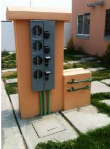
Ilustración 17 Instalaciones y acometidas subterráneas, tanto en suministro al inmueble como alumbrado público.
