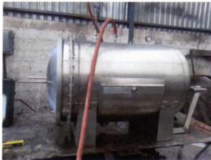
Figura 3.1 Biodigestor en prueba hidrostática.
