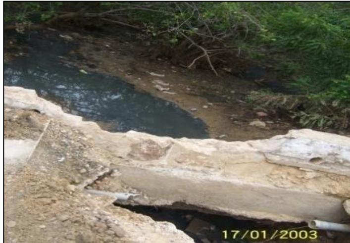
ALCANTARILLAS EN MAL ESTADO FIGURA 4.15
