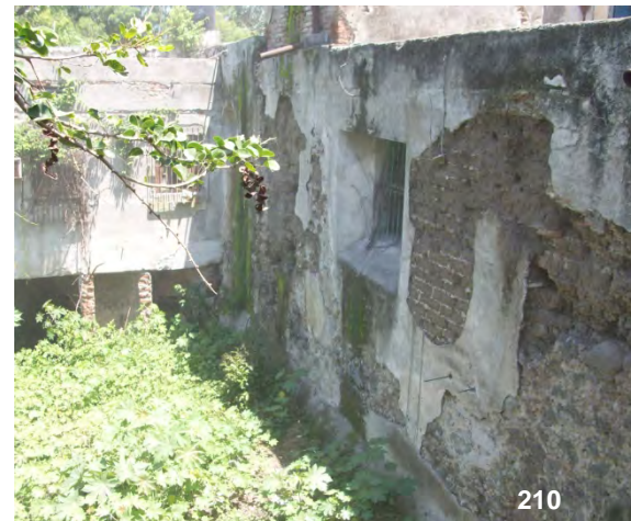
Imágenes 209 y 210.- Deterioros en muros de fachada del molino por humedades, pérdida y fatiga de elementos constructivos, etc. Fotos IPV. Diciembre 2011
