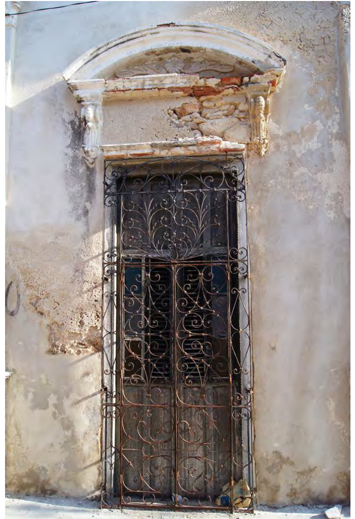
Imagen 94. Protector de herrería en ventana probablemente de finales del siglo XIX en una casa del siglo XIX ubicada en la calle 12A por Arista del barrio de San Francisco. Fuente: Fotografía de marzo de 2012, por el autor.
