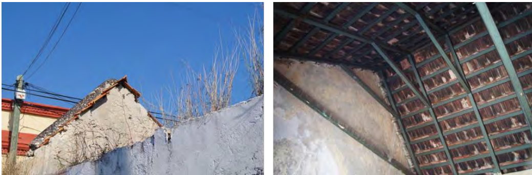
Imagen 88 y 89. Presencia de tejados en el barrio de San Francisco. Existen muchos colapsados como el de la imagen izquierda y algunos que han sustituido la estructura de madera, pero conservan las tejas de barro. Fuente: fotografías del autor, marzo-abril de 2012.
