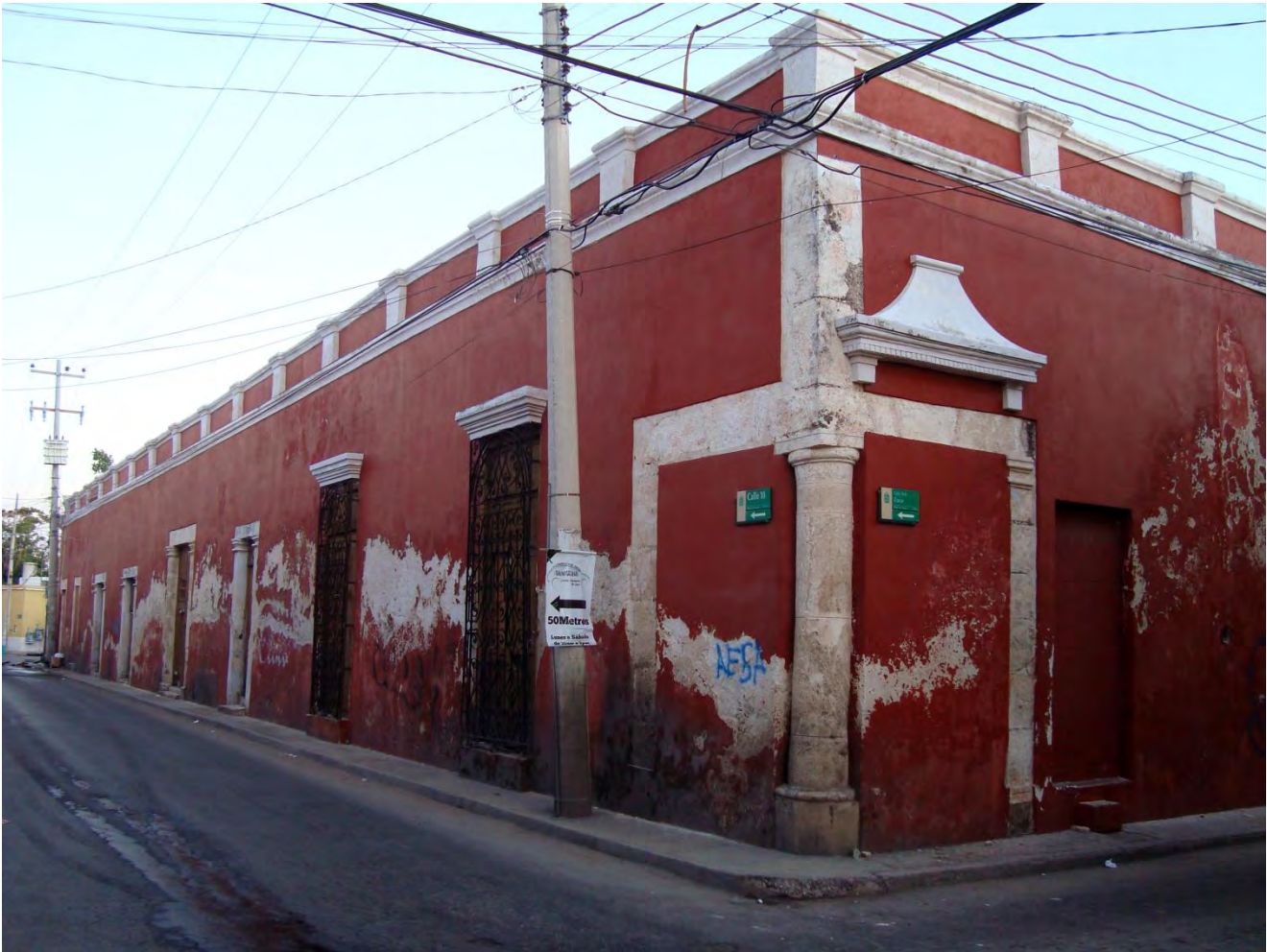
Imagen 65. Esquina sur oriente del inmueble 093, modelo de vivienda + comercio. Destaca la ubicación de dos accesos contiguos ubicados en la esquina separados por un pilar, esta tipología corresponde al de tienda esquinera. Fuente: fotografía del autor julio de 2011.
