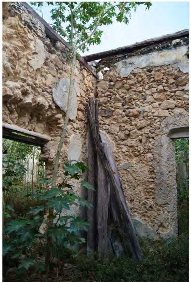
Imagen 80. Muro de mampostería en el inmueble 093. También se observa la solución de los cerramientos con vigas de madera. Fuente: Fotografía del autor, abril 2012.
