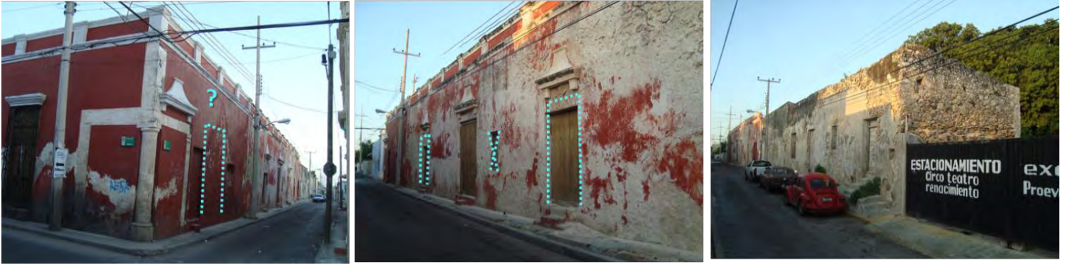
Imagen 100. Dificultades en la lectura de la fachada oriente. Fuente: Fotografías a color de julio 2011 y edición por el autor.
