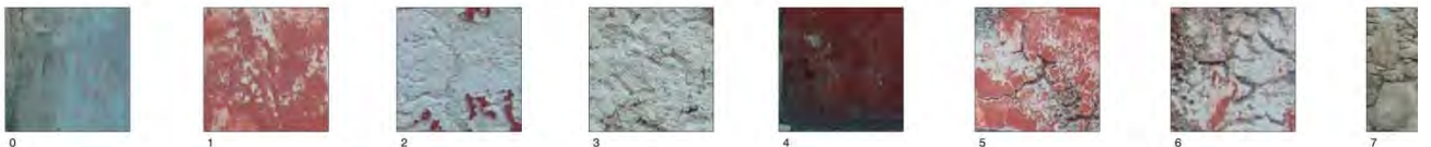
Deterioros en muros
