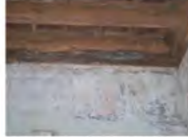
Falta de reintegración cromática en la pintura mural. En la parte superior existen resanes de materiales distintos a los utilizados originalmente. 09
