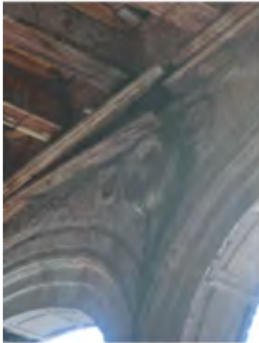
En la parte superior, hay presencia de humedad en la madera y en el arco. Las vigas son usadas como nidos de aves. 01
