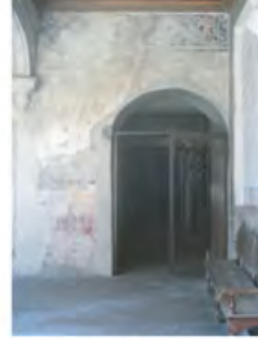
El muro presenta resanes de reciente manufactura. El marco de la puerta está despostillado y deteriorado. 04
