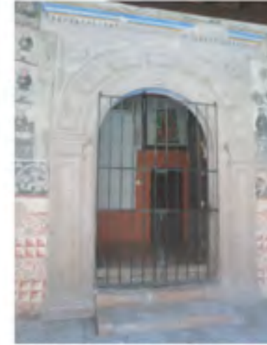
La puerta presenta deterioros. Los escalones presentan disgregaciones en algunas de sus partes y falta rejunteo. 06
