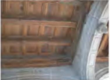
Las vigas de madera se encuentran con polillas y suciedad. Hay instalación eléctrica visible y escurrimientos en los arcos. 08
