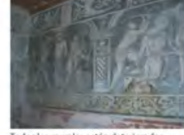
Todos los murales están deteriorados, algunos tienen humedad y otros tienen resanes de materiales distintos a los utilizados originalmente. Falta reintegración cromática. 11
