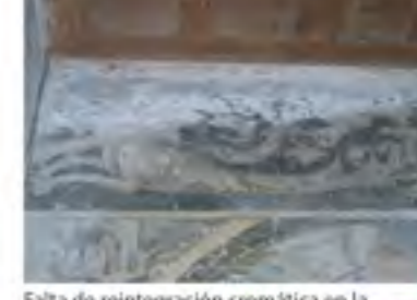
Falta de reintegración cromática en la pintura mural. En la parte superior existen resanes de materiales distintos a los utilizados originalmente. 12
