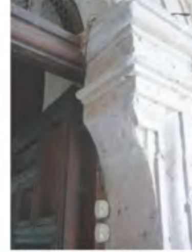
Instalaciones eléctricas ubicadas en los marcos de las puertas del claustro. Se presenta exfoliación en la cantera. 05
