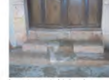
La puerta presenta deterioros. Los escalones presentan disgregaciones en algunas de sus partes y falta rejunteo. 10
