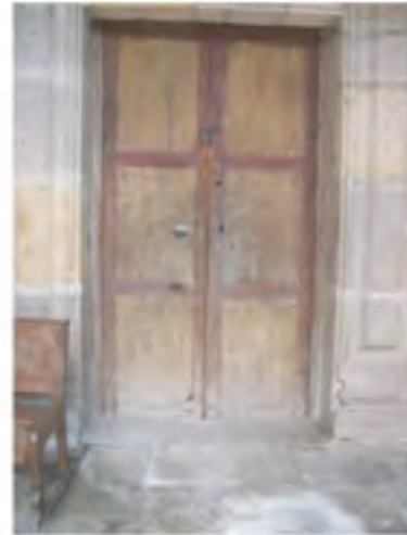
La puerta presenta deterioros, hay exfoliación en la cantera y muestras de humedad en el piso. 03
