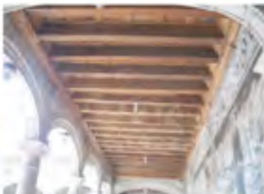
Las vigas presentan humedad e instalación eléctrica visible por el paso de la mayoría de las vigas. 07
