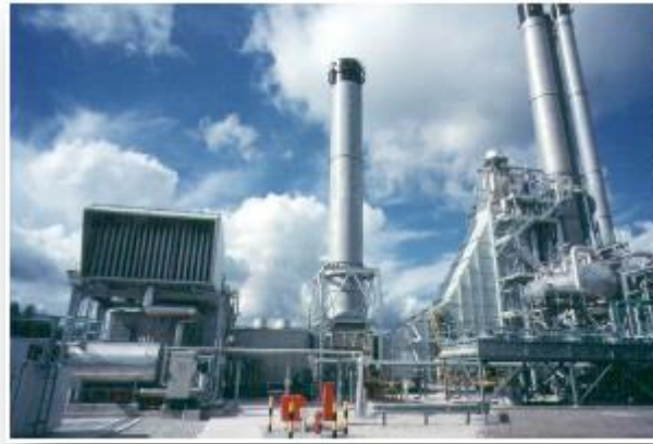
Figura 2.13 Instalación de planta de generación de energía eléctrica con tecnología de turbina de gas. Fuente: CRE.
