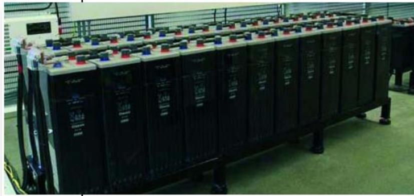
Figura 1.21 Baterías electroquímicas. Fuente: Labein – Tecnalía.
