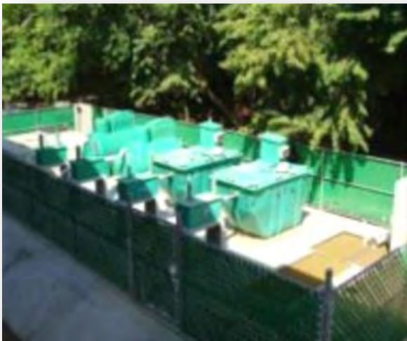
29.-CARCAMO DE RE-BOMBEO.
