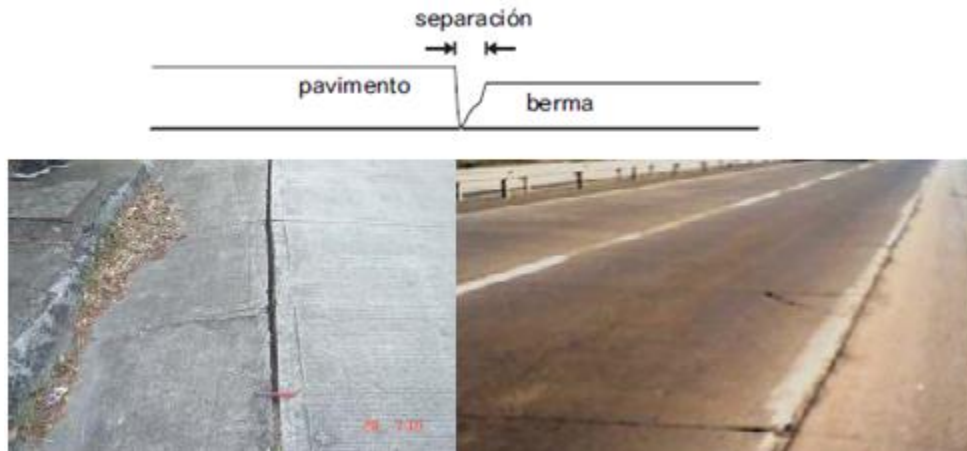
Imagen 4.39 Separación entre berma y pavimento.
