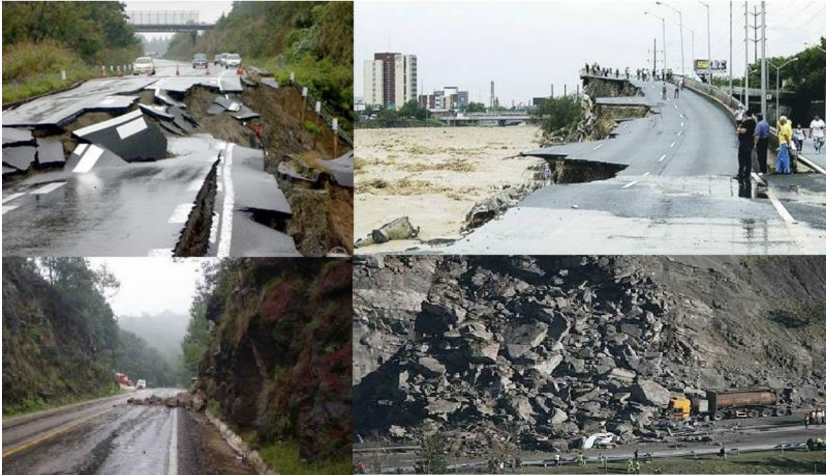
Imagen 4.42 Efectos de sismos, huracanes y derrumbes.
