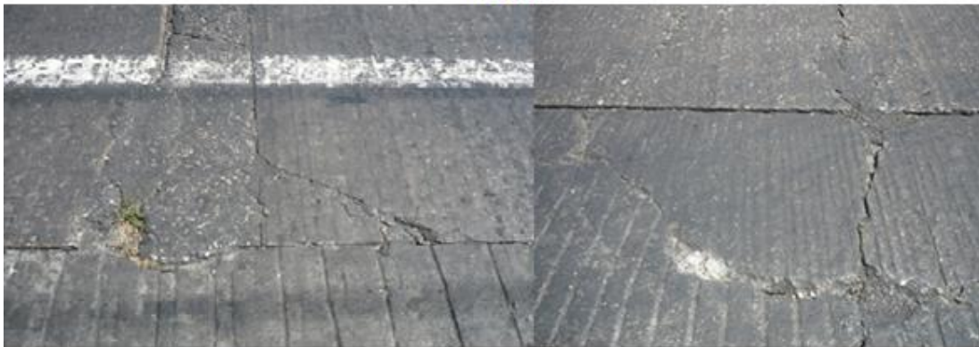
Imagen 4.25 Grietas de esquina.
