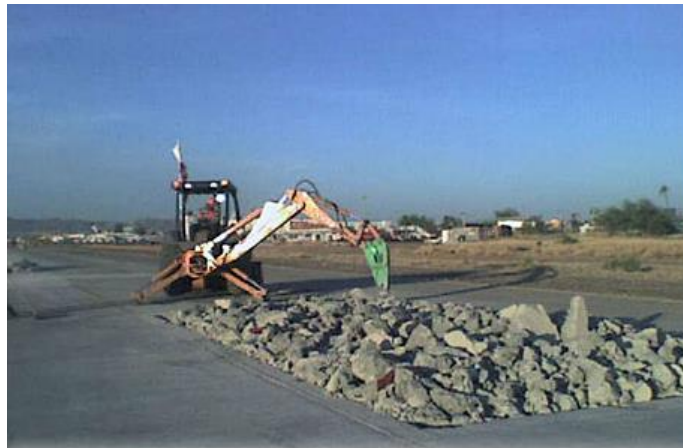
Imagen 5.14 Fragmentación del concreto deteriorado.
