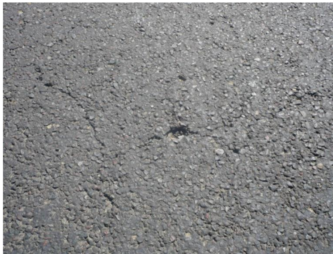
Imagen 4.2 Desprendimiento de agregados.
