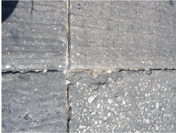
Imagen 4.22 Deficiencia del sellado.
