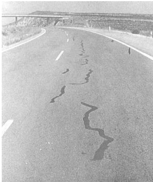
Imagen 4.19 Grietas en zig-zag.
