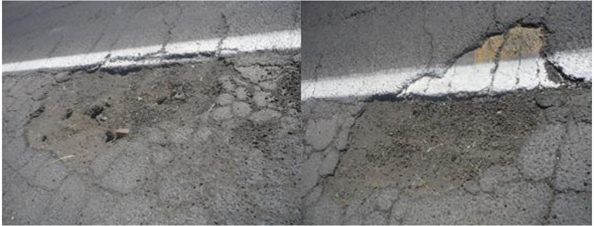
Imagen 4.1 Pérdida de agregados/Pérdida de la base/Bache superficial.
