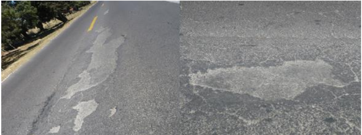
Imagen 4.4 Pérdida de capa de rodadura/Desprendimiento de sello.
