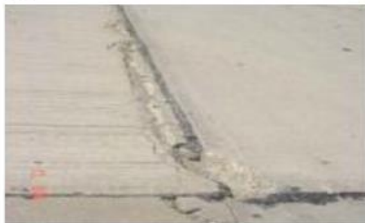
Imagen 4.23 Juntas saltadas o despostilladas.
