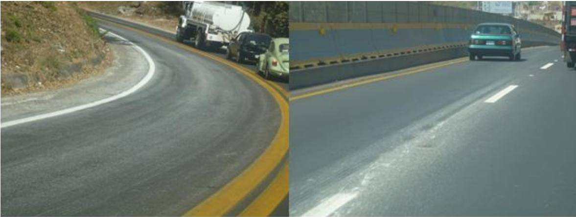
Imagen 4.8 Expulsión de finos y afloramiento de humedad.
