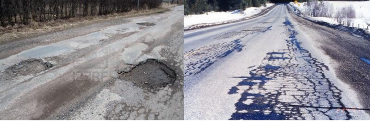
Imagen 4.43 Desprendimiento por congelación.
