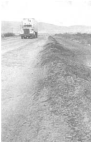
Imagen 4.13 Desplazamiento de la sección del pavimento.
