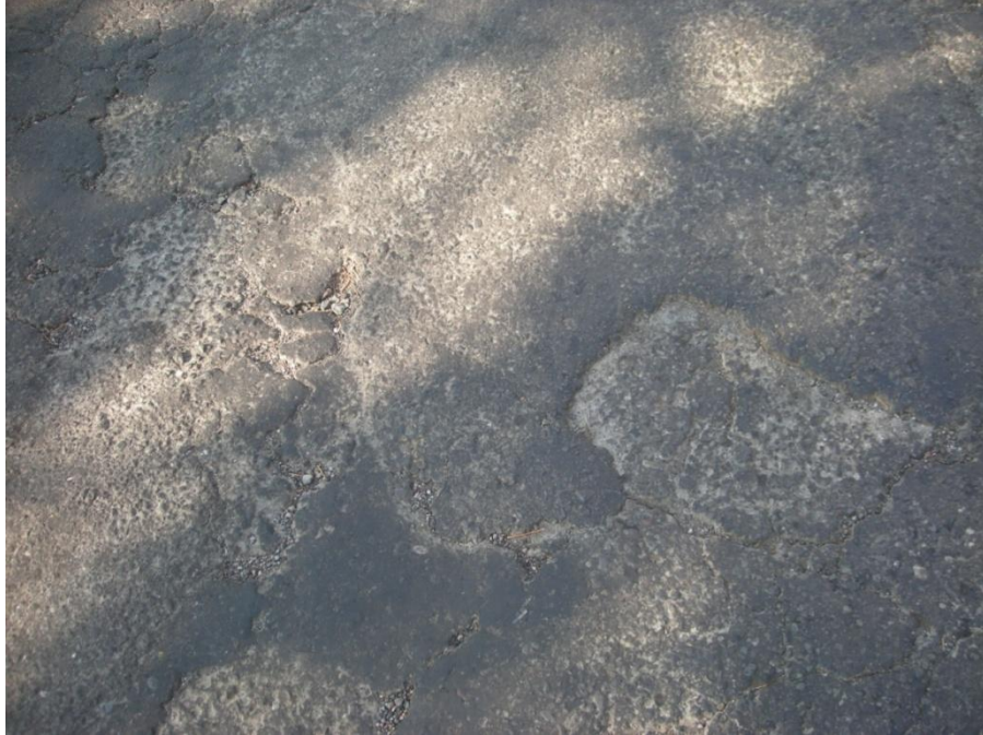
Fotografía 3.4 Estado actual del camino con deterioro visible (Fuente: Propia)
