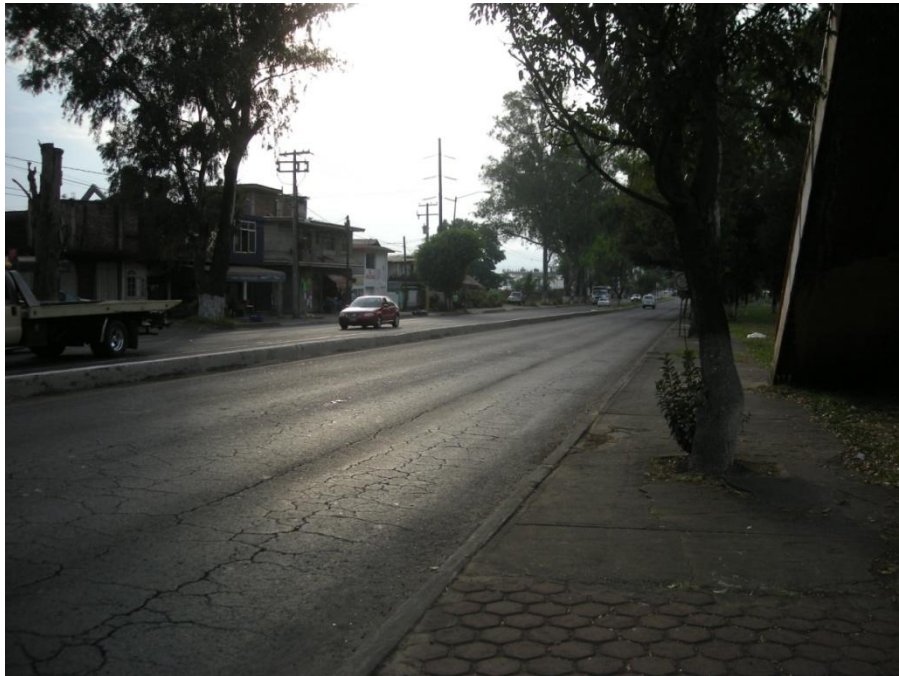
Fotografía 3.5 Estado actual del camino con desgaste en toda su superficie (Fuente: Propia)
