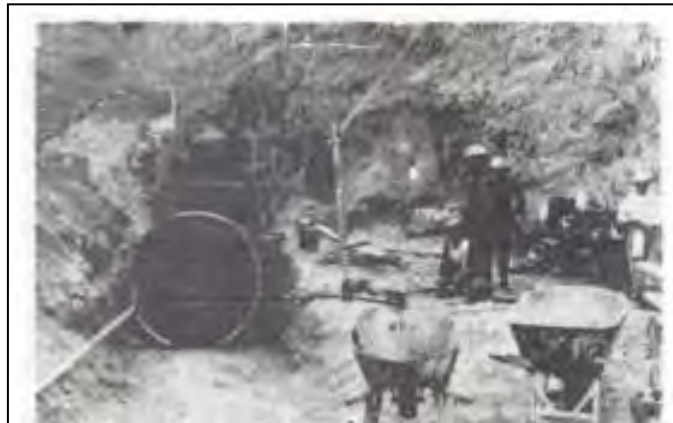
Fig. 2.7. Entrada a galería filtrante.
