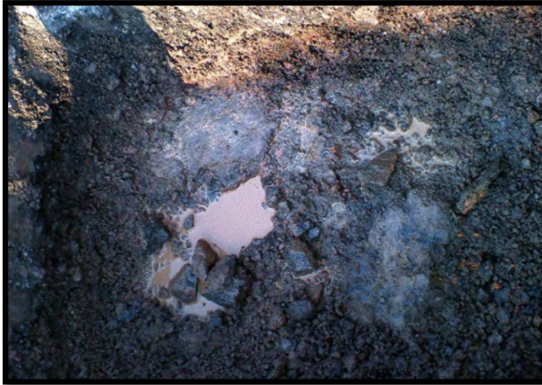
Filtración en plena base hidráulica.
