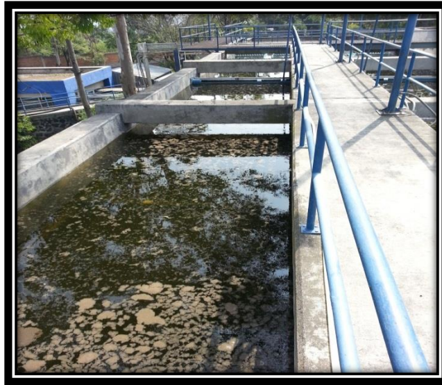
Figura 3.47 Sedimentador secundario, se almacenan los lodos en una tolva y se recirculan hacia los reactores biológicos.
