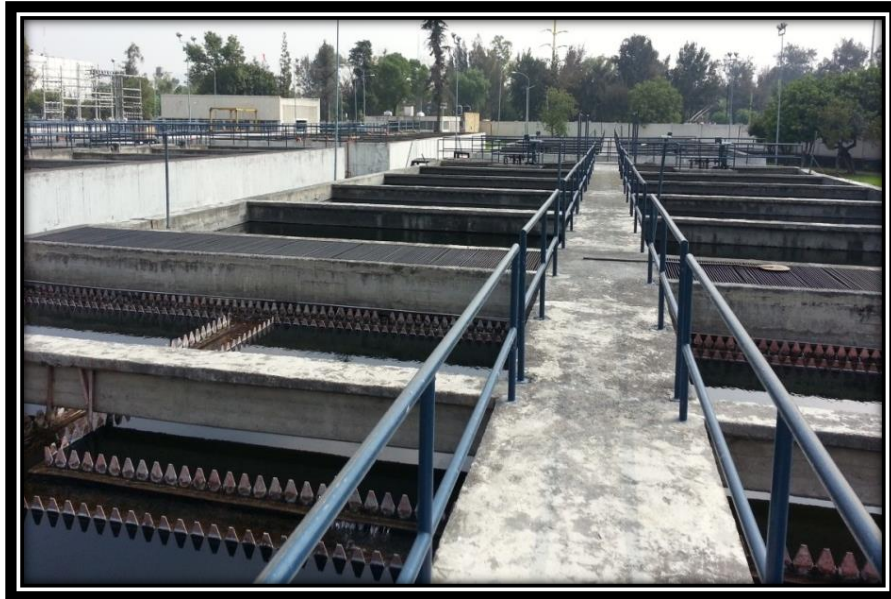
Figura 3.21 Vista general de uno de los tanques de sedimentación secundaria con sus respectivos clarificadores.
