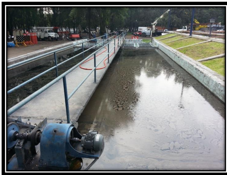
Figura 3.32 Tanques de sedimentación primaria en el tren de tratamiento I. Se observa que los motores de las dragas se encuentran deteriorados y no están protegidos contra el clima.
