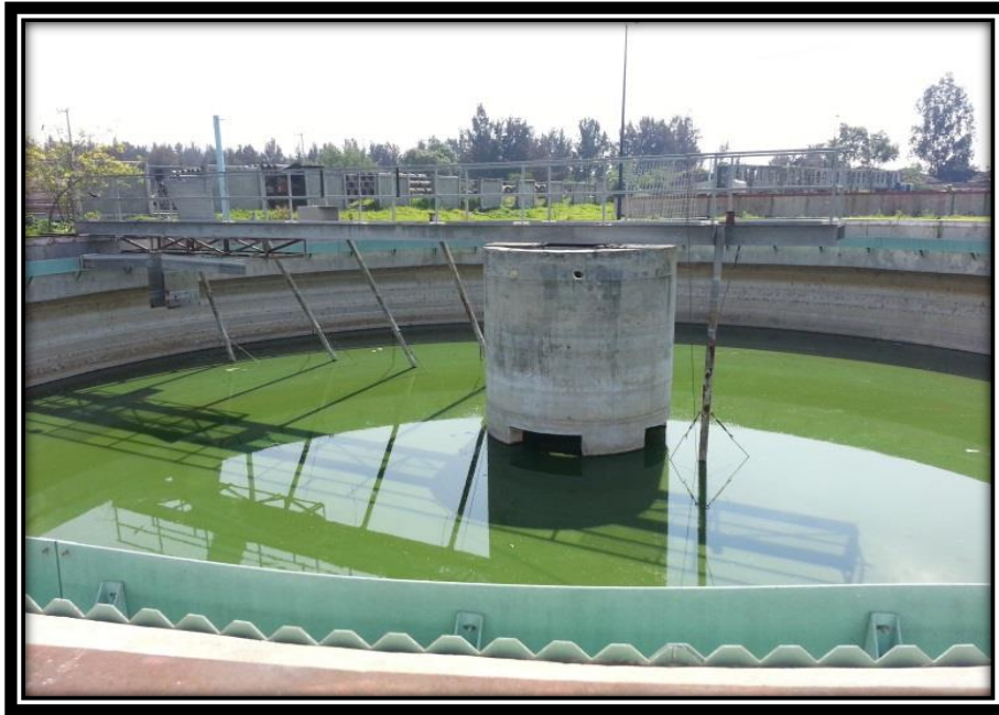
Figura 3.41 Tanque de sedimentación secundaria, fuera de servicio por falla mecánica desde hace alrededor de 8 años por falta de presupuesto para su reparación.
