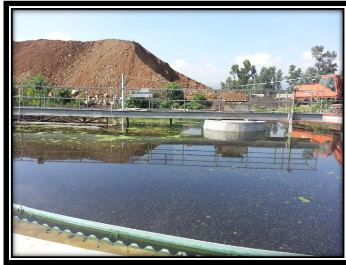
Figura 3.39 Vista general de uno de los tanques de sedimentación secundaria. Presenta un estado de pésimo mantenimiento pero funciona adecuadamente.
