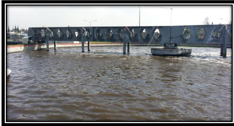
Figura 3.37 Vista general de uno de los reactores biológicos, los 2 reactores que se encuentran en operación presentan falla mecánica en el brazo recolector de lodos.
