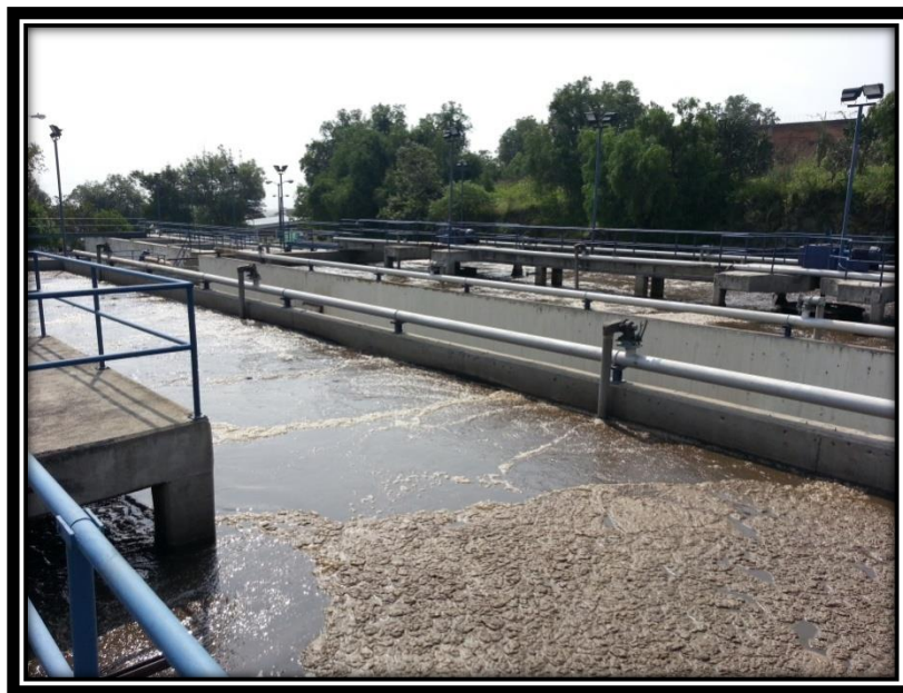
Figura 3.46 Vista general de uno de los reactores biológicos rectangulares de la planta. Se observa acumulación de lodos en la superficie debido a fallas eléctricas en los aireadores.
