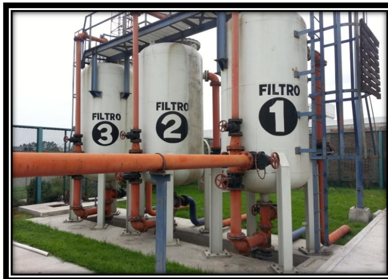
Figura 3.13 Módulos de filtración, último paso del tratamiento del agua antes de ser bombeada hacia el reclusorio.
