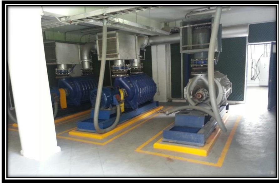
Figura 3.31 Equipos sopladores que abastecen de oxígeno a los reactores biológicos. Uno de los equipos se encuentra parcialmente desmontado.
