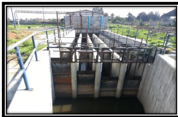
Figura 3.36 Compuertas reguladoras de gasto y rejillas de limpieza mecánica a la entrada del agua residual a la planta.
