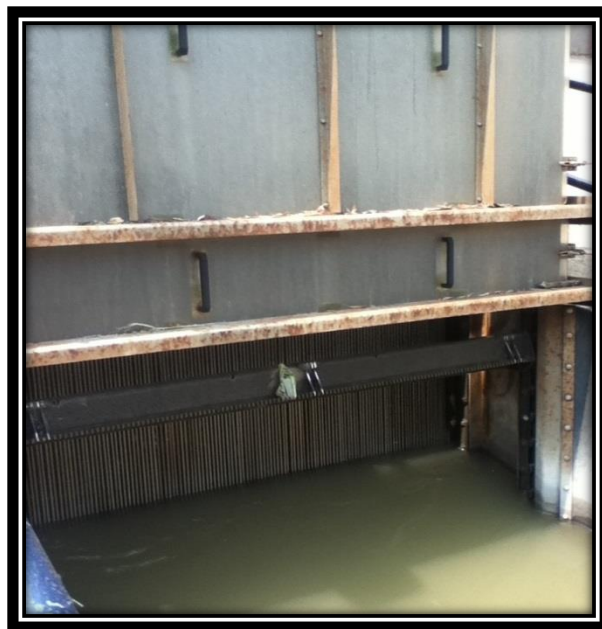
Figura 3.2 Rejillas de limpieza mecánica
