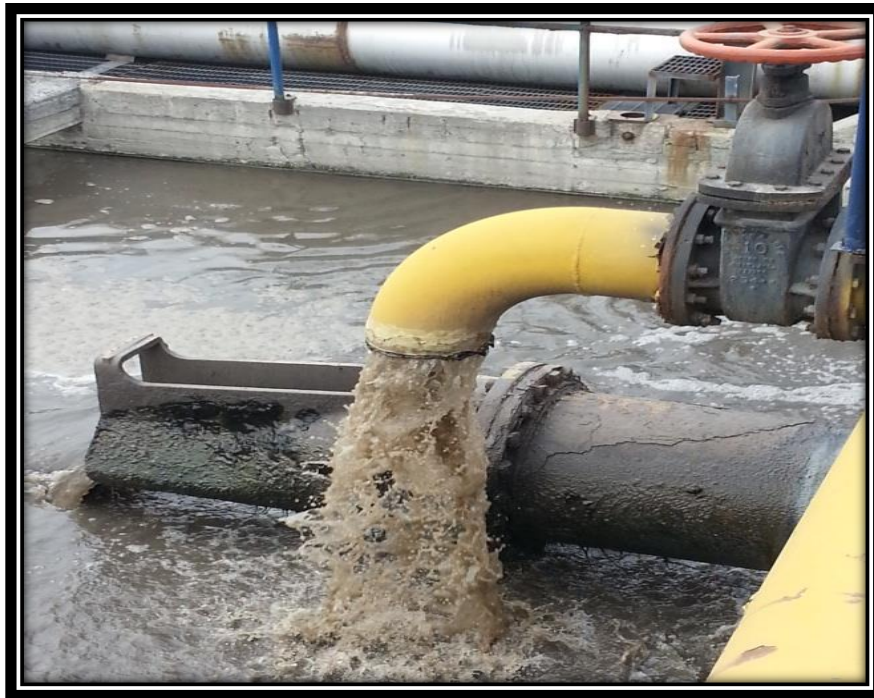
Figura 3.6 Imagen del sistema de recirculación de lodos instalado en uno de los reactores biológicos.
