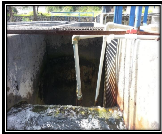
Figura 3.48 Instalación para la desinfección del efluente del tratamiento secundario con hipoclorito por goteo.
