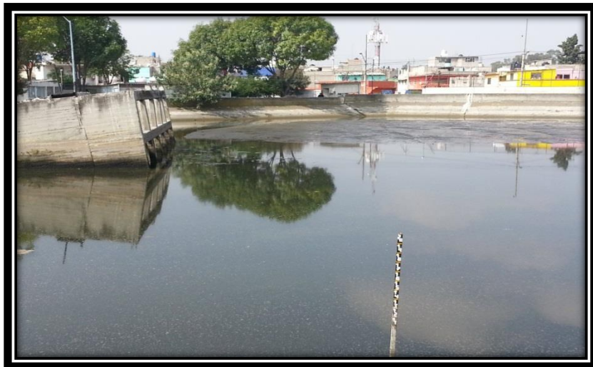
Figura 3.23 Vista general del tanque de almacenamiento de agua tratada. Se aprecian con claridad los daños que ha causado el hundimiento diferencial del terreno de la planta en la estructura del tanque.
