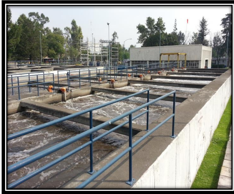
Figura 3.19 Vista general de uno de los reactores biológicos, se observa la instalación para la inyección de aire comprimido en color naranja.
