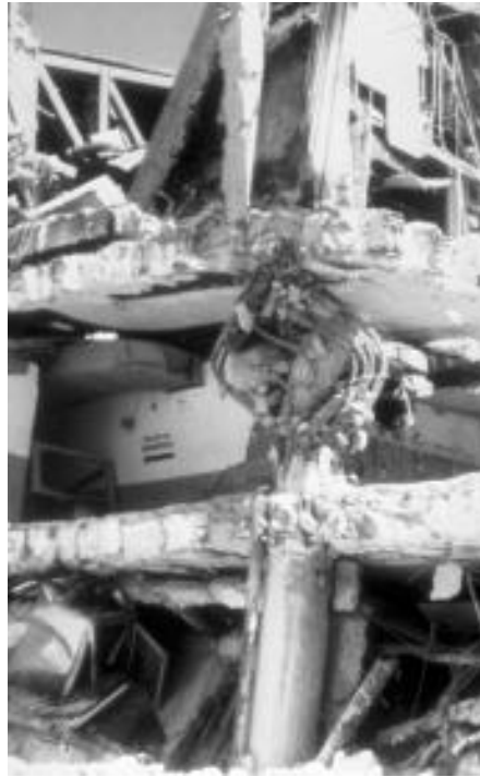
Figura 2.18 Colapso de un edificio de concreto reforzado causado por el sismo de 1985 en la ciudad de México. (Fascículo Cenapred
