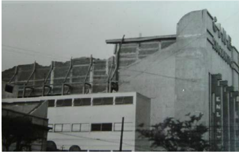
Figura 2.11 Cine Encanto que perdió el techo y parte de los muros, (Reinoso y Orozco, 2007).
