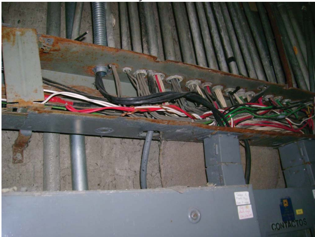
Ducto Panta Baja
