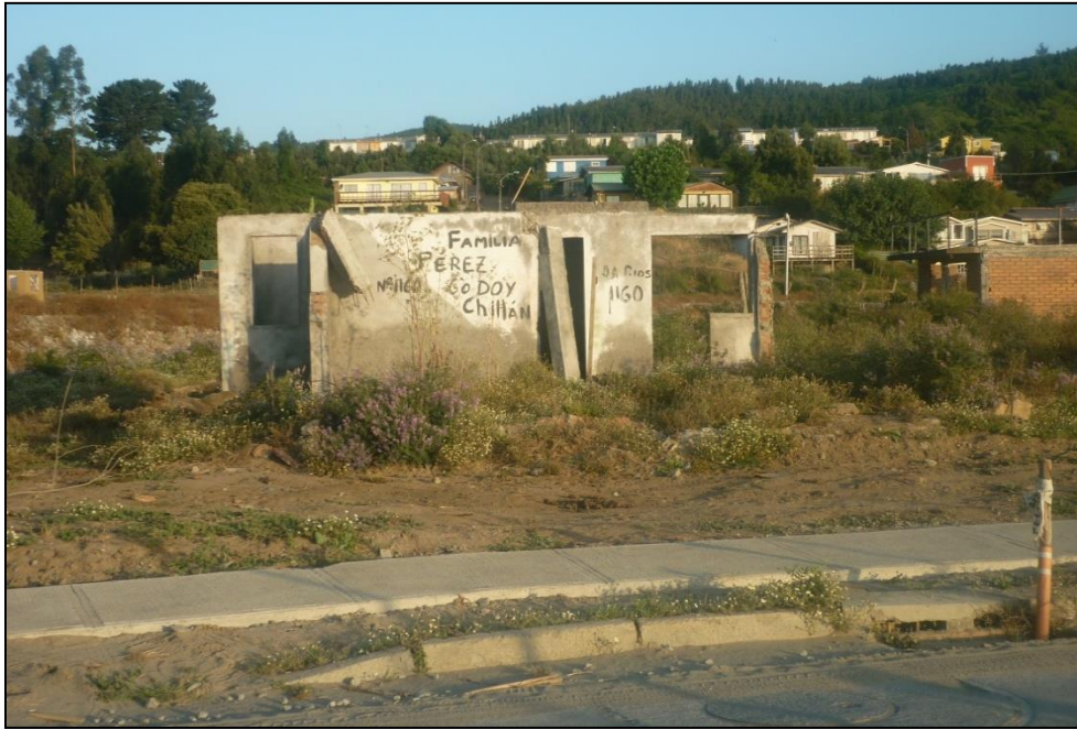
Figura 24: Estructura de concreto que resistió parcialmente el impacto del tsunami en Dichato
