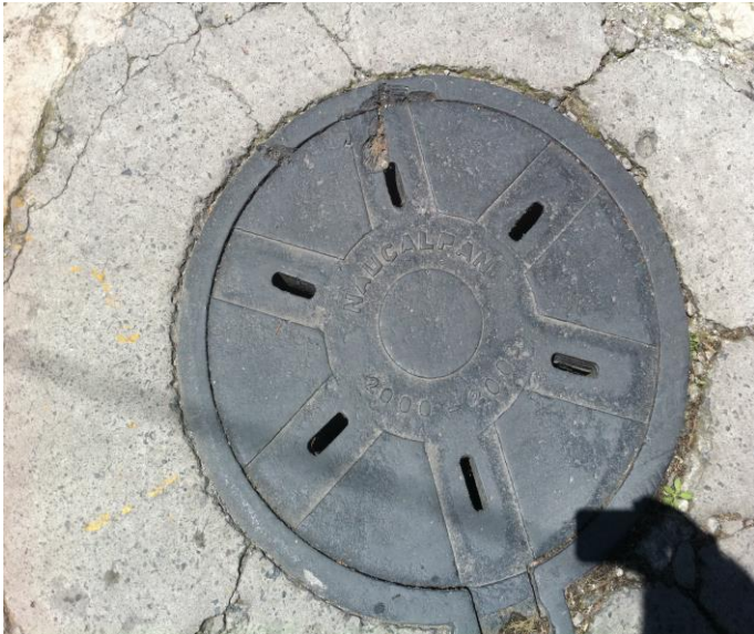
Foto 3. Servicios de alcantarillado, Col. Tercer Mundo. Fuente: Trabajo de campo, Noviembre 2012.
