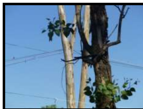
Imagen 14. Árboles usados como postes de luz.
