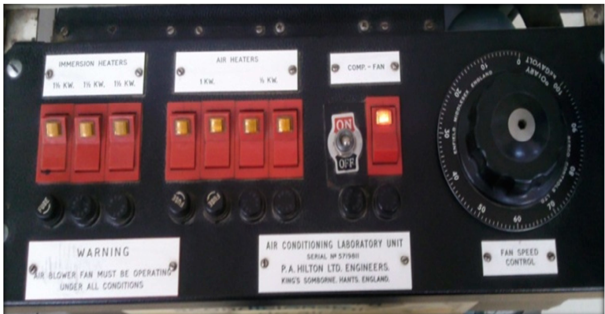
FIGURA III-5. Panel de control para encender y ajustar la velocidad del ventilador, encender los calentadores de inmersión, las resistencias eléctricas y el circuito de refrigeración
