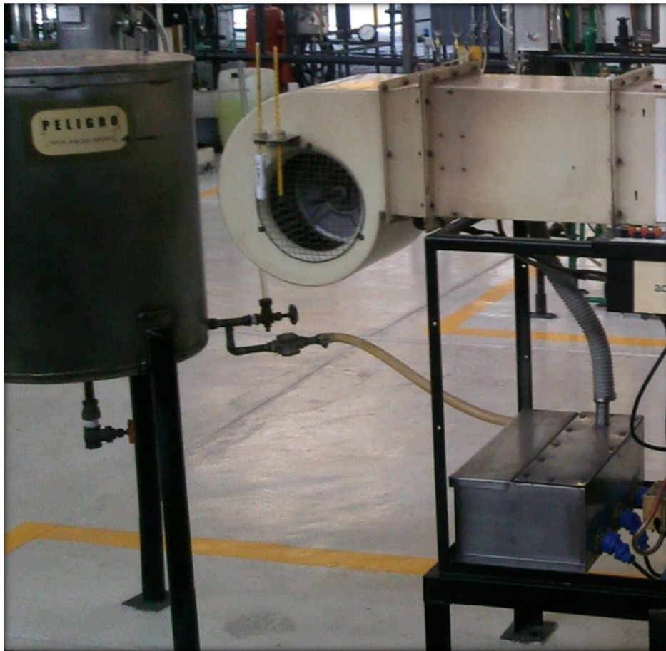
FIGURA III-3. Zona de la caldera: alimentación de agua para generar vapor y humidificar el aire
