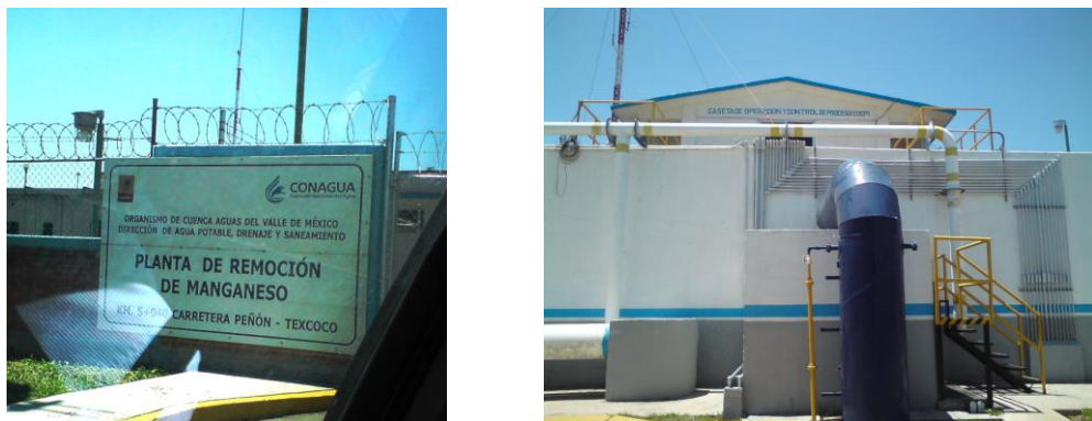
Figura 12. Fotografías de la Planta de Remoción de Manganeso, punto donde se junta el agua de los pozos para ser tratada.
