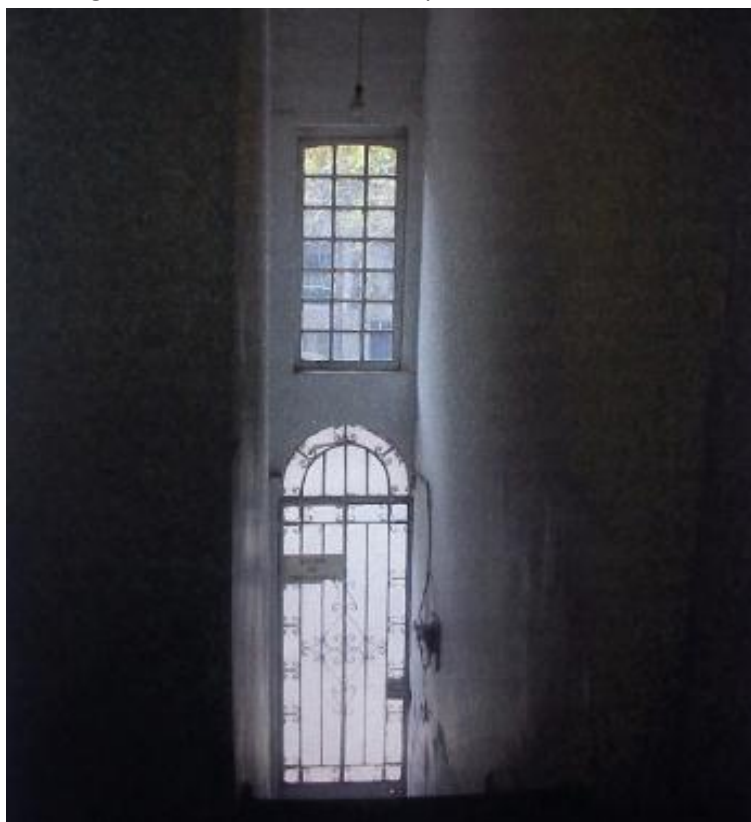
Agrietamiento en acceso a departamento de Nivel
