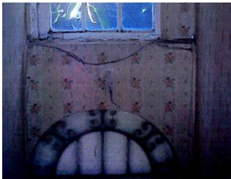
Agrietamiento en cubo de escaleras a nivel 1
