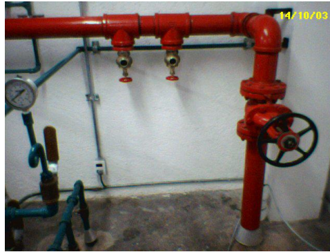
Vista frontal de las válvulas de prueba sobre cabezal de descarga
