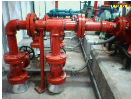
Succión tipo para las bombas de PCI
