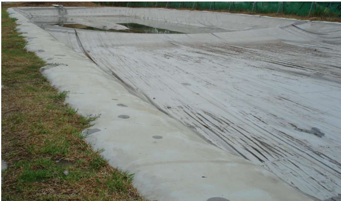
Figura 25. Cisterna de almacenamiento del sistema de captación del CIDECALLI
