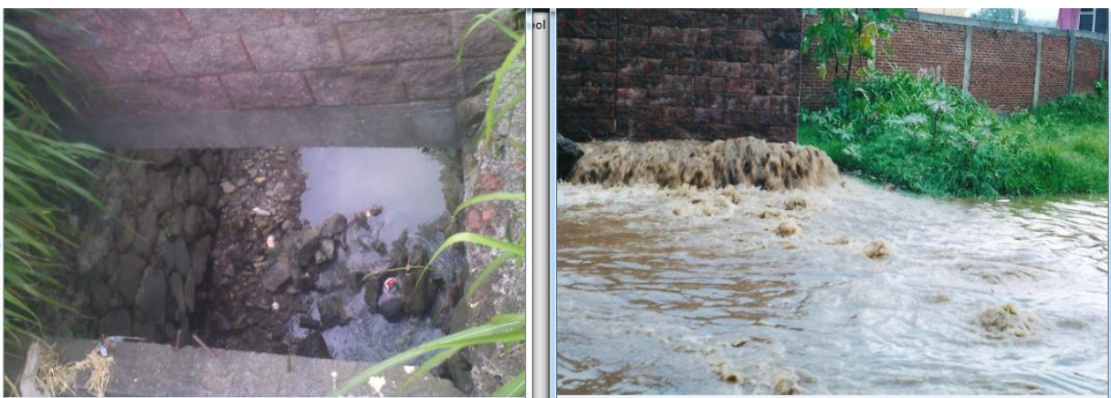
Fotografía. 4.22. y 4.23. Calle Bolivia, estación 0+300. (Fuente: Propia)
