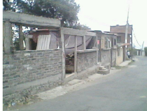
Vivienda mal estructurada
