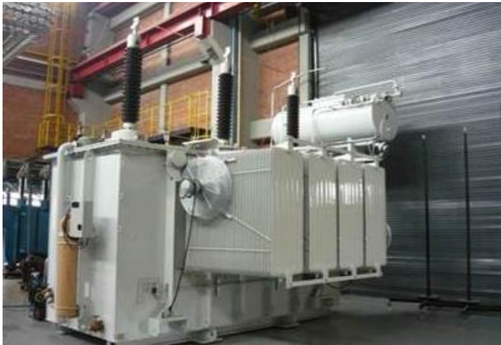
Figura 2-18. Transformador con sistema de refrigeración forzada.
