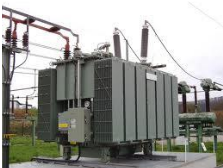
Figura 2-1. Transformador de potencia.
