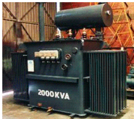
Figura 2-16. Transformadores con enfriamiento tipo Pyraleno.
