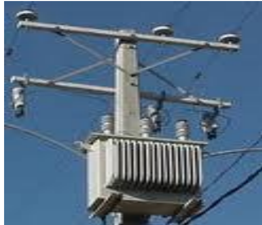
Figura 2-13. Transformador para exteriores.
