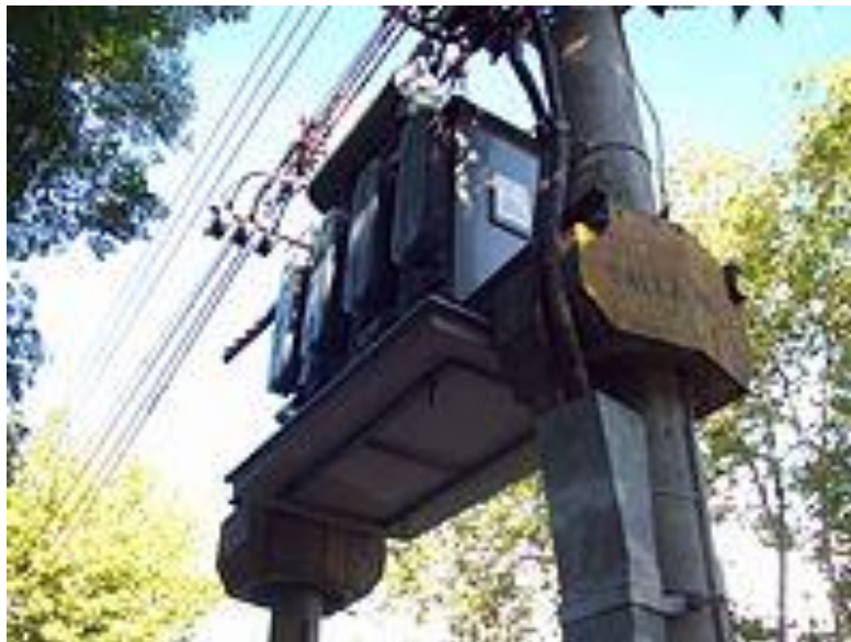
Figura 2-11. Transformador reductor de tensión.
