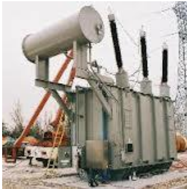
Figura 2-10. Transformador elevador de tensión.
