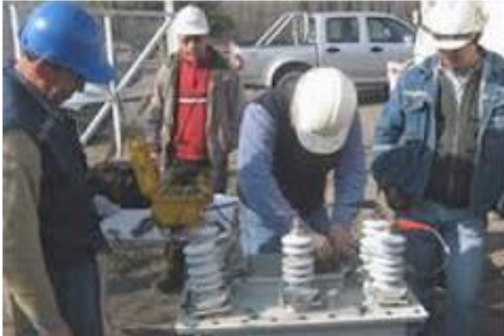
Figura 4-2. Revisión periódica de pasatapas de un transformador.
