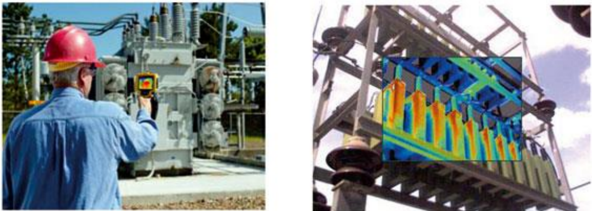
Figura 4-3. Inspección del sistema de ventilación de un transformador a través de cámaras termografías.
