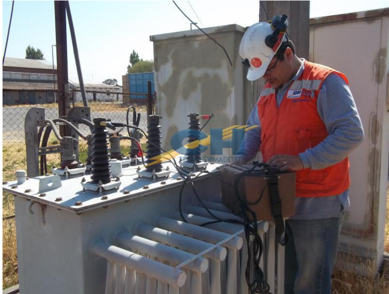
Figura 4-7. Medición de nivel de tensión, para verificar el buen funcionamiento del cambiador de TAPS.
