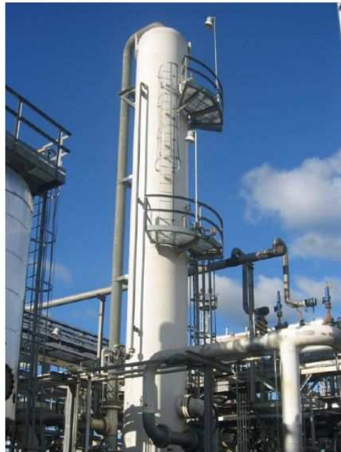
Contactora de gas-Glicol
