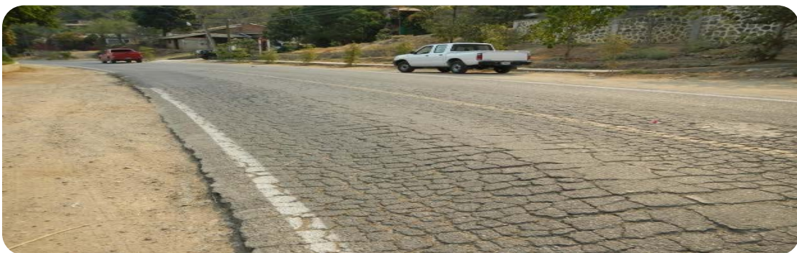
Fig. 1.2.2 Falla en superficie de rodamiento.
