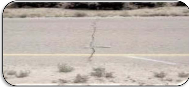
Fig. 4.1.1.1 Agrietamiento por baja temperatura
