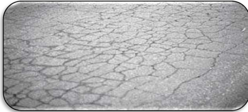
Fig. 4.1.2.1 Agrietamientos por fatiga
