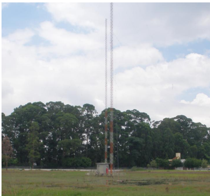
Figura 3.4. Sistema de antenas y casa de sintonía.
