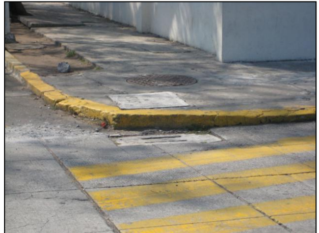
FIGURA 45: Foto tomada por el autor, vista del servicio de agua
