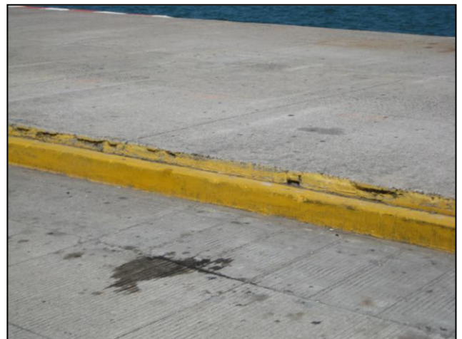
FIGURA 49: Vista de la guarnición en mal estado
