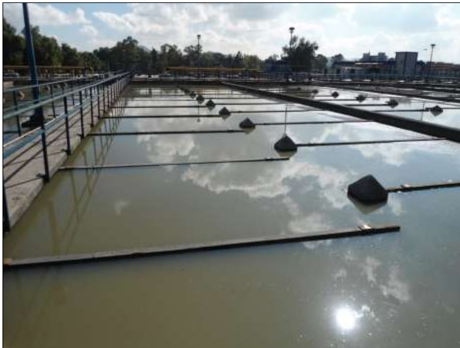
Figura 5.3. Sedimentador primario Planta de Tratamiento Cerro de la Estrella.
