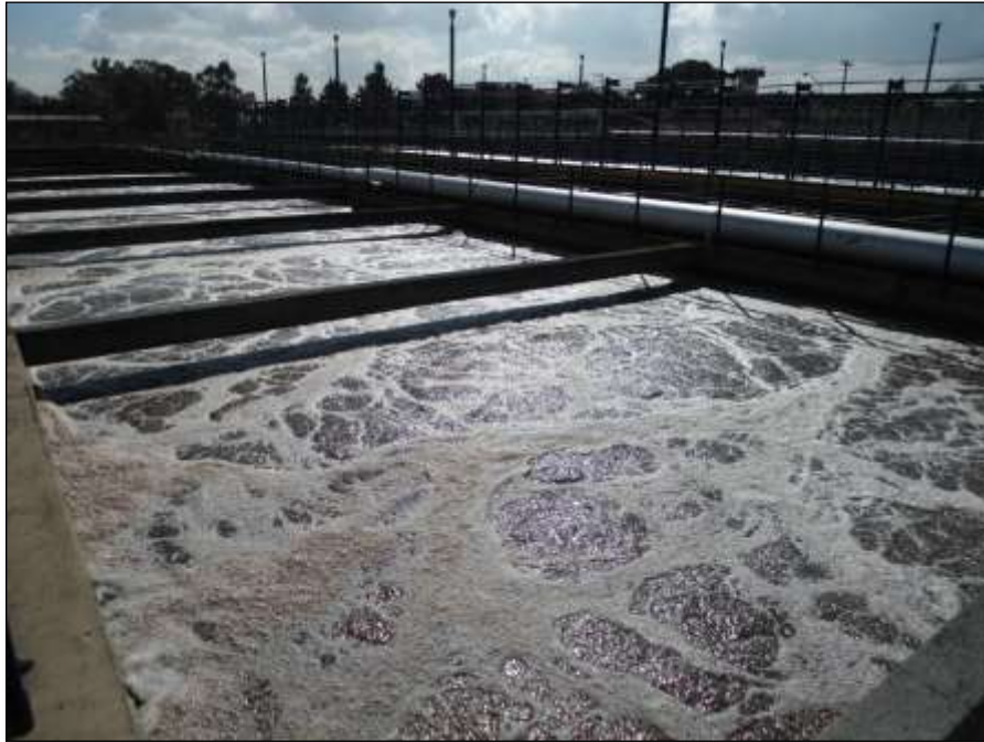
Figura 5.4. Sistema de Lodos Activados Planta de Tratamiento Cerro de la Estrella.
