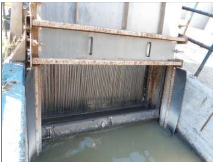
Figura 5.2. Sistema de criba tamiz Planta de Tratamiento Cerro de la Estrella.
