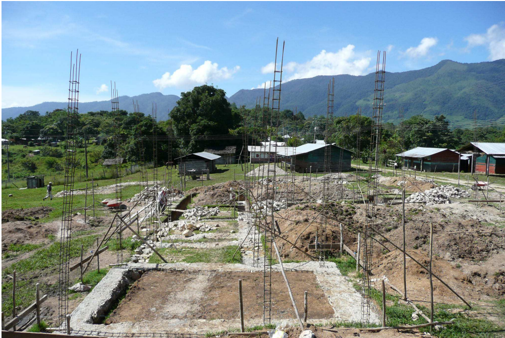
2. Trabajos de excavación y cimentación. Vista de norte a sur. Al fondo se puede ver el templo catolico (a la derecha) y su cocina (a la izquierda), que tambien sirvio como cocina para todos los que participamos en la construcción de la clinica.
