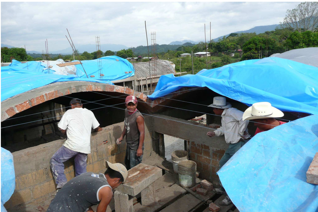
5. Ultima etapa del pegado del ladrillo en la boveda, en la cubierta del laboratorio.
