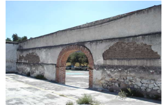
Fig. 33 Notamos el deterioro de la fachada poniente de la casa de servidumbre
