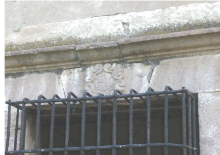
Fig. 46 Deterioro de la decoración de una cornisa a base de cantera
