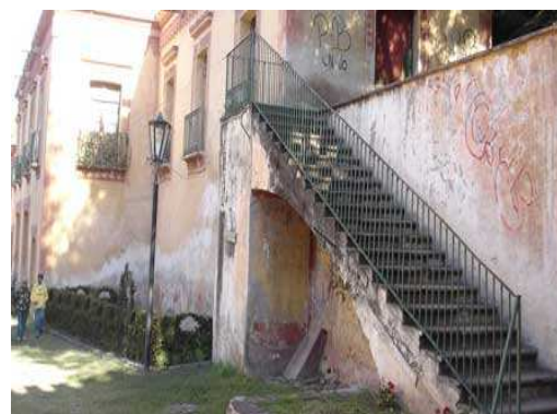
Fig. 58 Deterioro de la escalera
