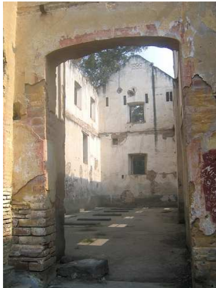
Fig. 55 Notamos el deterioro en los acabados de jambas y muros
