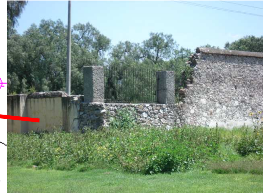
Fig. 38 Aquí uno de los muros exteriores fabricado a base de adobe y ya colapsado por le erosión
