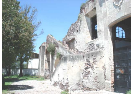
Fig. 45 Acceso a una de las bodegas de grano y vista del deterioro de una escalera adosada a la fachada
