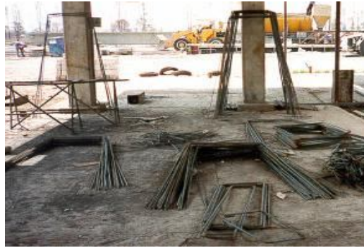
Vista de las instalaciones para almacenaje y preparación de acero en planta
