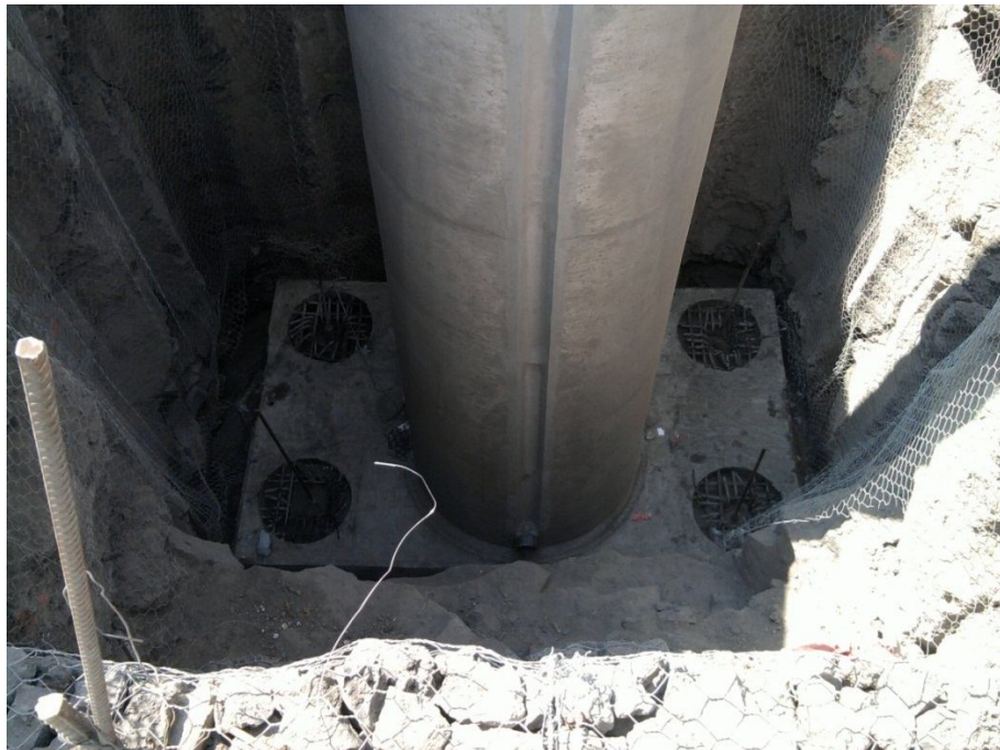
Barras de presfuerzo columna prefabricada
