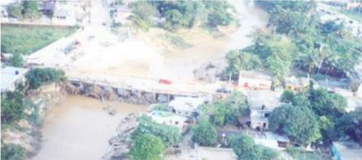
Figura 1.7 Retención de basura en las pilas de los puentes de cruce
