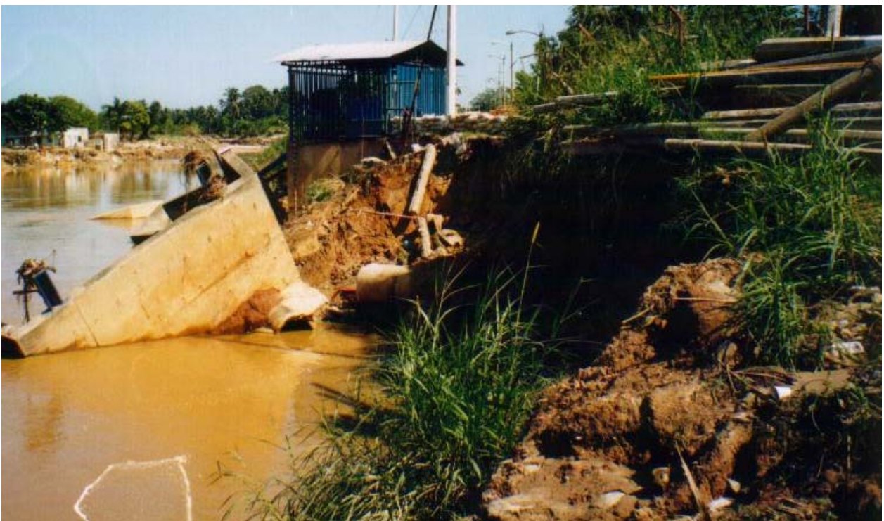
Figura 3.4 Vista de la constitución de material del cauce del arroyo Agua Dulce, tramo aguas abajo
