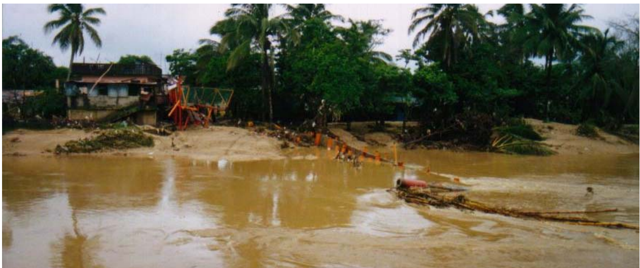
Figura 3.13 Puente destruido. Obstrucciones en el cauce
