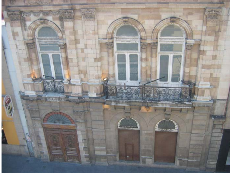
Fachada Principal del Edificio Uruguay 49. La fachada en la parte inferior fue trabajada en cantera Chiluca y la superior con Blanca Pachuca. Tiene cortinas de acero por el uso comercial a su anterior ocupación. La carpintería ya está muy dañada en planta alta; el portón principal será restaurado. La herrería de los balcones es de hierro forjado.
