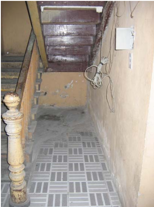
Retiro de escaleras de madera en cubo para elevador de servicio para personas con diferentes capacidades.
