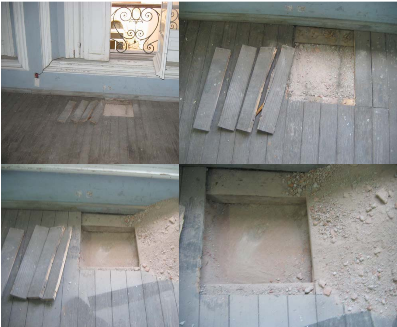
Secuencia de fotografías de las calas realizadas en el entrepiso del tercer nivel
