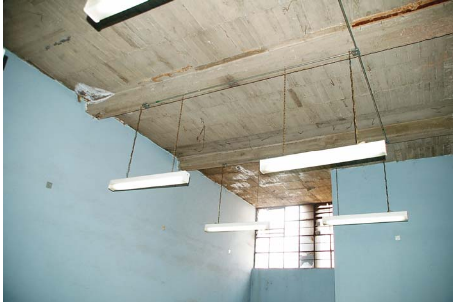
Fotografía de salón en la parte trasera del inmueble. La losa es de concreto armado al igual que las traveses de refuerzo.
