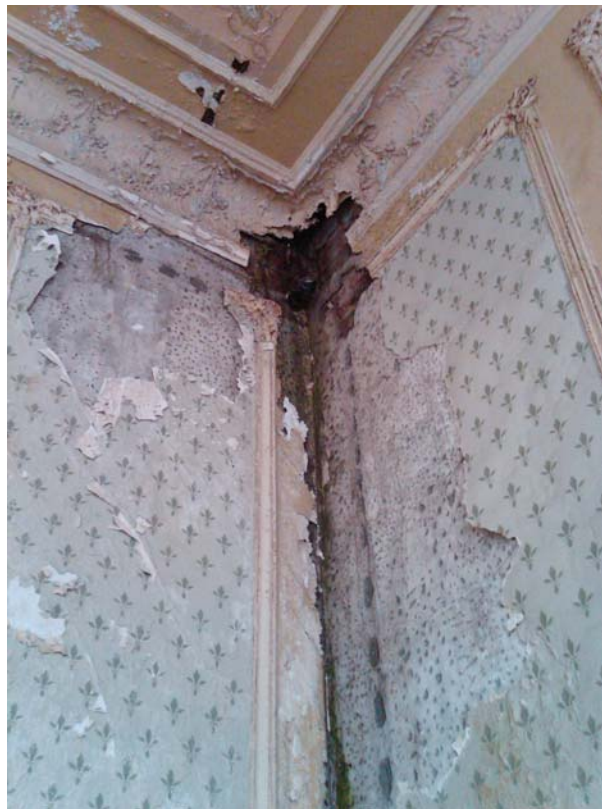
Fotografía del salón principal. Bajada pluvial dañada.
