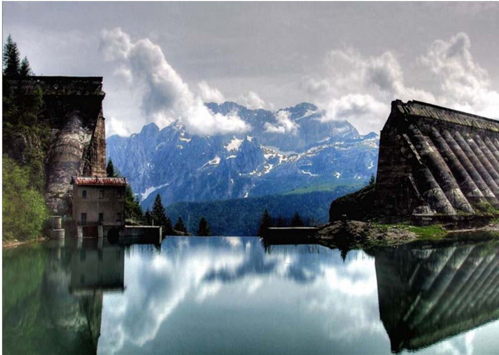
Fig. 4.12 Colapso parcial de la presa Pian del Gleno, Valle de Scalva, Italia (imagen tomada de la Ref.28).
