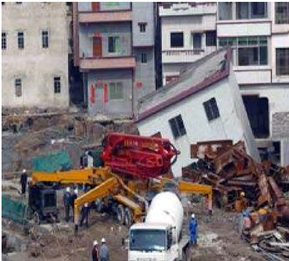
Fig. 4.26 Hundimiento de edificios debido a falla en muro diafragma del túnel de la línea 3 del metro, en Guangzhou, China. Imagen tomada de la Ref.11 Internet, pág.94).
