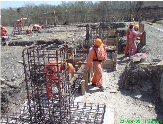
Habilitado y colocación de acero de refuerzo acero f_y = 4,200 \text{ kg/cm}^2 19 mm. (núm. 6).
