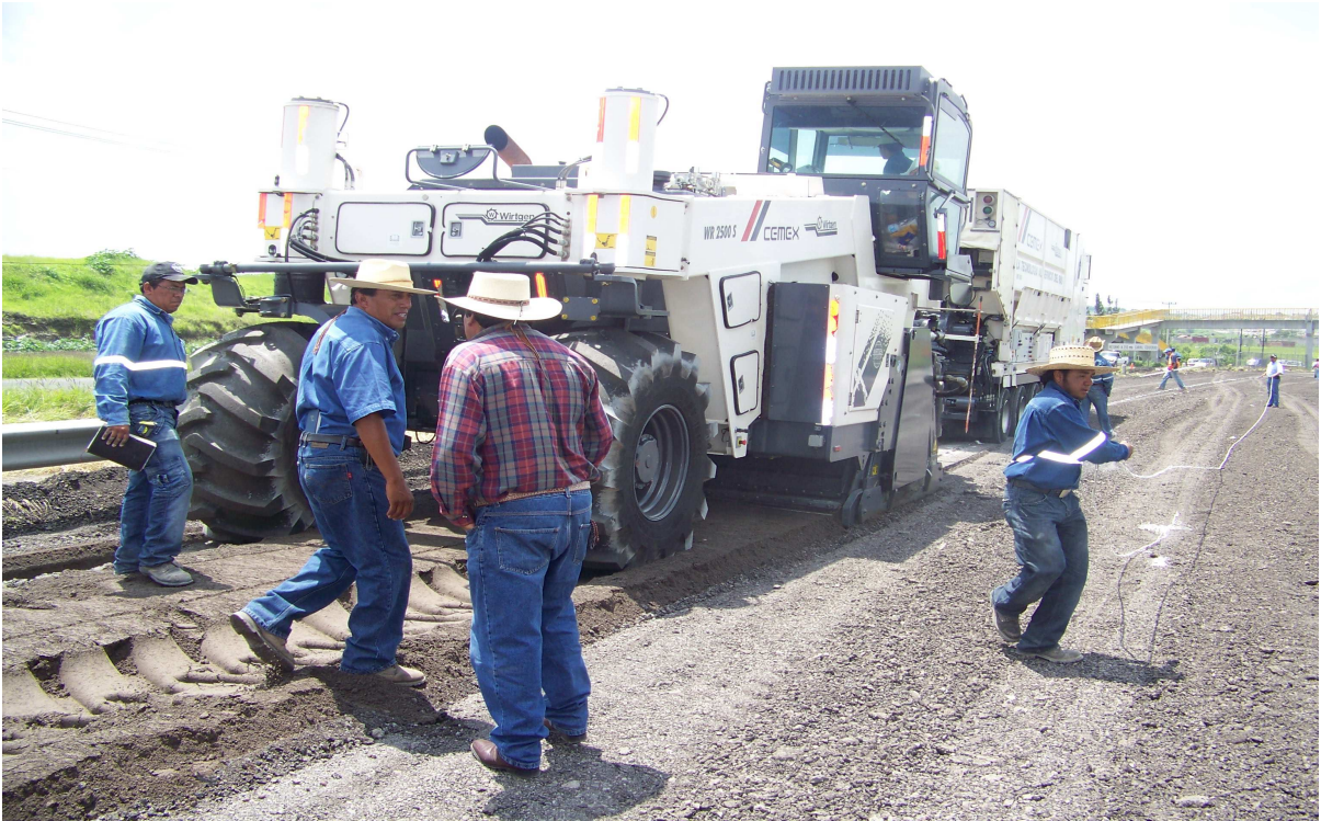
Foto No. 16 a) Equipo en proceso de trabajos de recuperación de pavimentos efectuado en el Libramiento Cuautla
