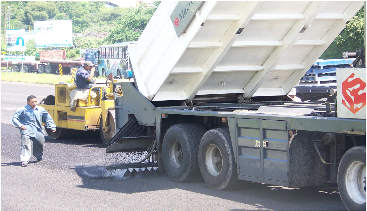
Foto No. 13 b) Riego de sello, del tipo sincronizado, observándose el riego de liga y el esparcimiento del pétreo simultáneamente.
