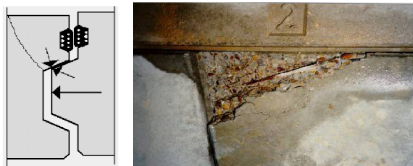
Figura 4.11 Esquema de formación de rotura por carga excéntrica de empuje y fotografía real del daño.
